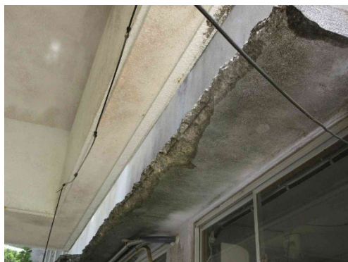
外壁の爆裂（教室棟4－1号棟）
