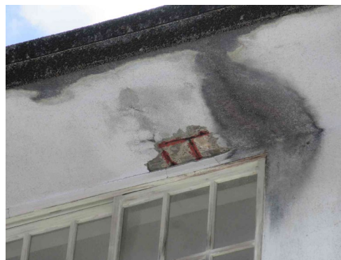
庇の爆裂（教室棟6－1号棟）
