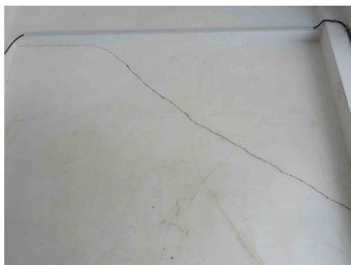
外壁のクラック（教室棟6－2号棟）
