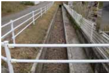
側溝等の早急な土砂除去が望まれる（阿木名地区）
