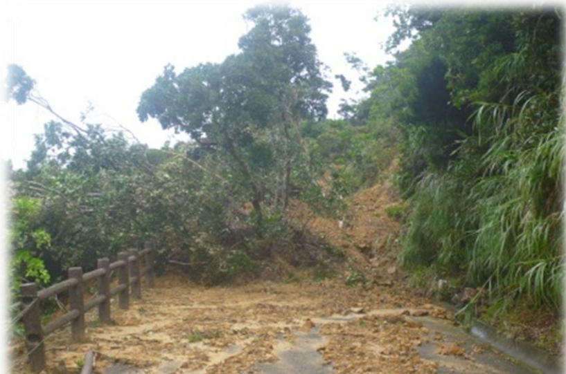
崖崩れの状況（安脚場戦跡）
